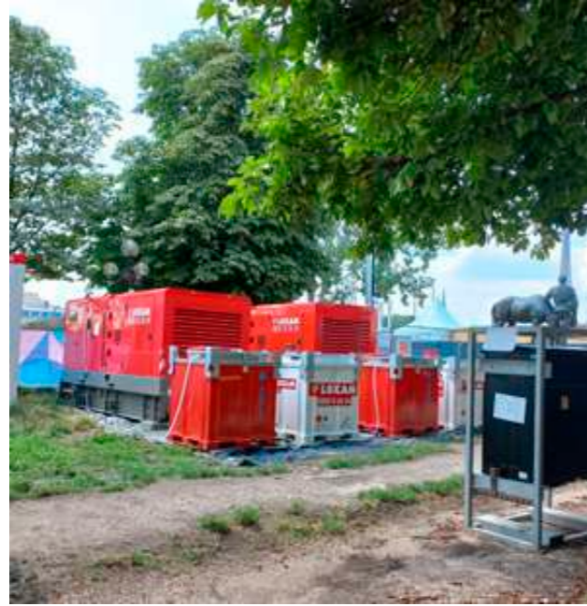
Site Grand Palais-Alexandre III – Groupes électrogènes de secours et cuves sur bâche – Crédit Paris 2024 (JMA)
