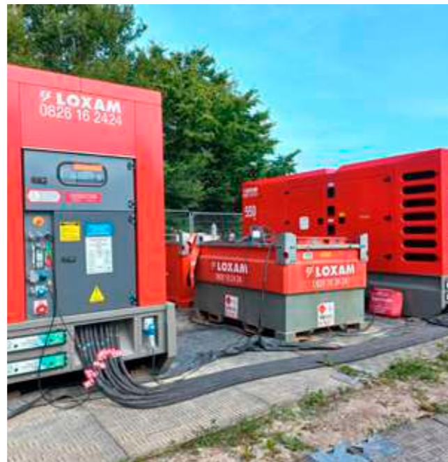
Site du Vélodrome de Saint-Quentin-en-Yvelines – Groupes électrogènes de secours et cuves sur bâche – Crédit Paris 2024 (JMA)
